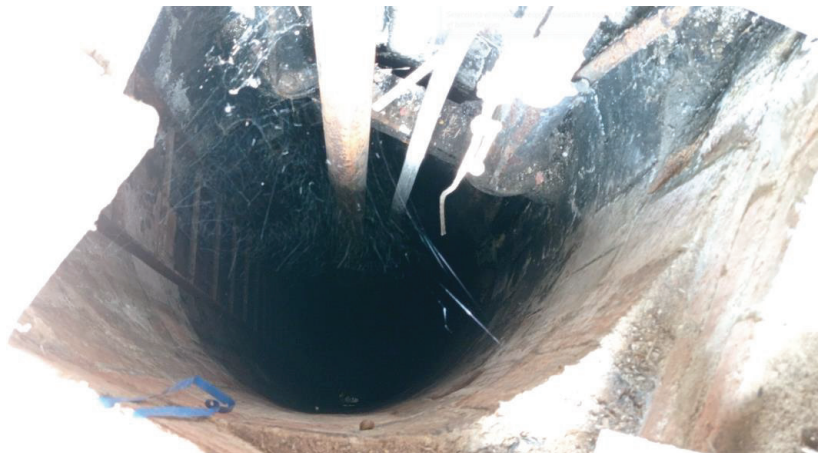
Figura 3.3.-Captació d'aigües subterrànies en desús i existent a la zona central de la parcel·la zona i (Foto de l'autor: 25/04/25)
