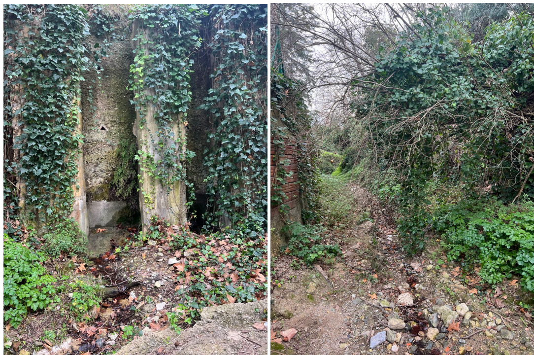
Fotos. Zones on es produeixen filtracions d'aigua d'una mina des del mur de delimitació i petits entollaments d'aigua. Font: ©Eduardo Soler
