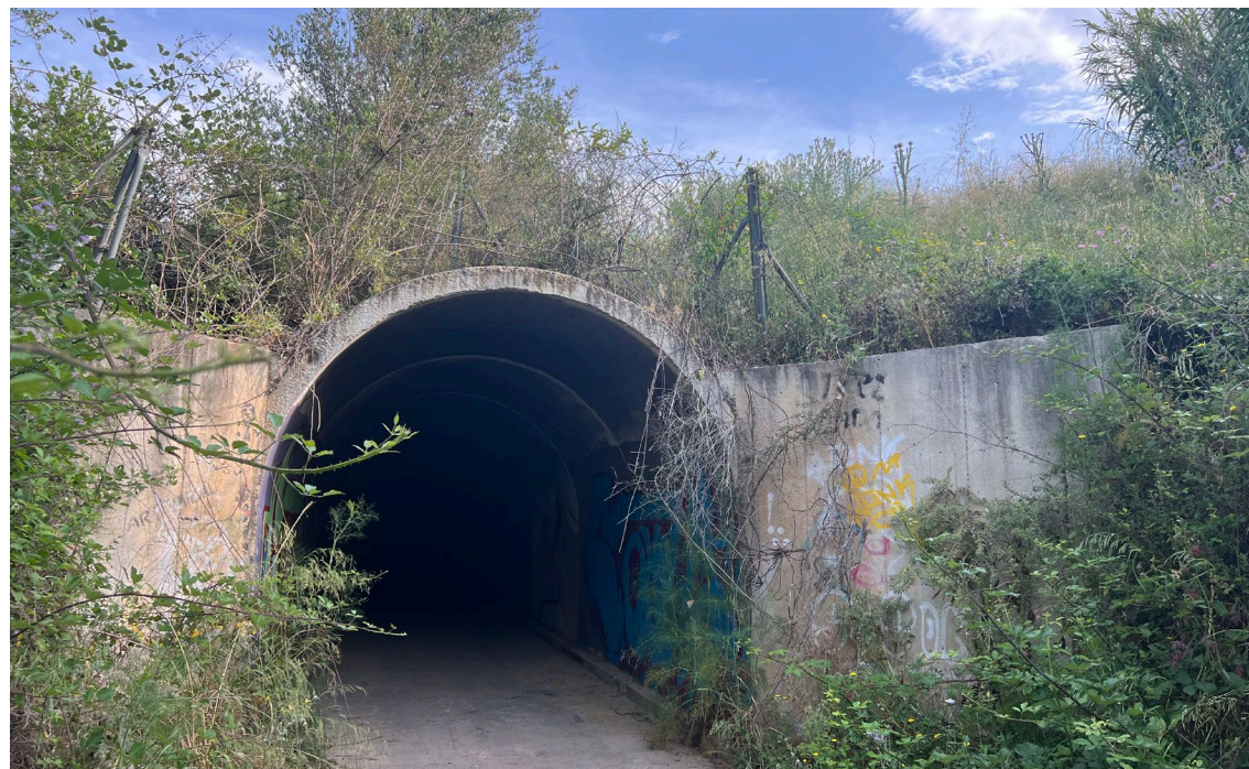
Foto. S'ha de reforçar la tanca de torsió damunt de l'obra de fàbrica per evitar la caiguda. Font: ©Eduardo Soler
