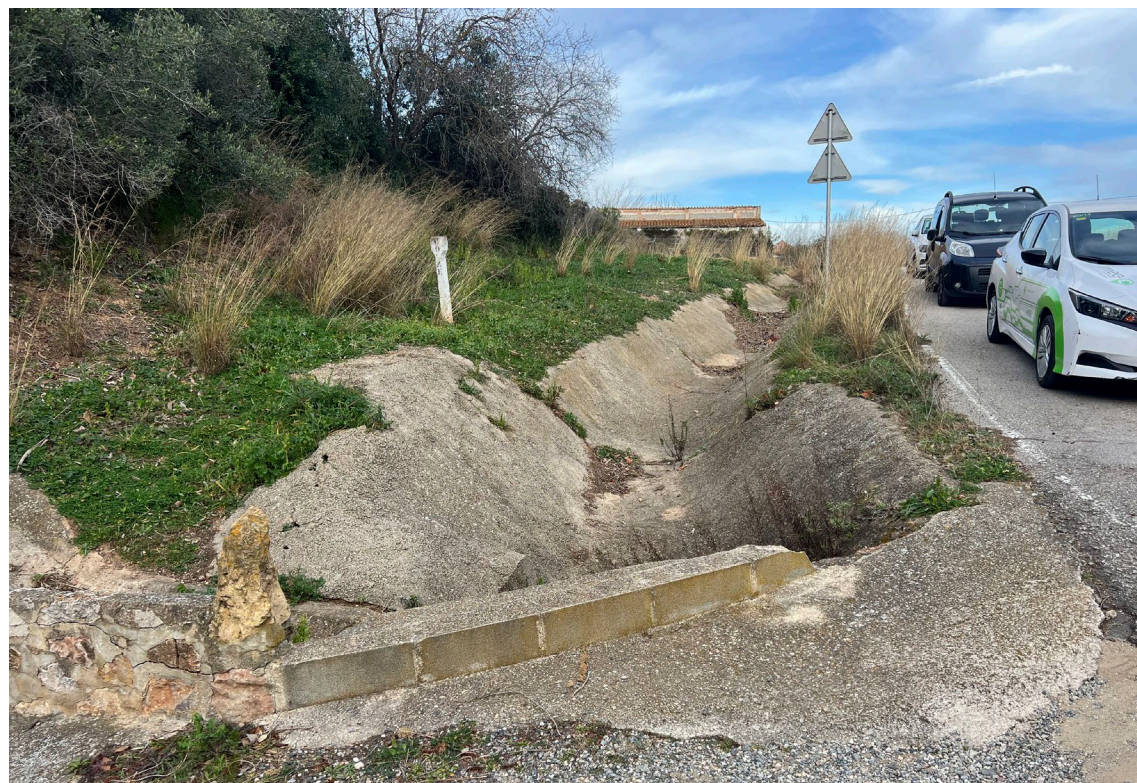
Foto. Drenatge de formigó que porta les aigües cap al barranc del Molí des del passeig del Nord abans del creuament amb el Passeig de la Boca de la Mina. Font: ©Eduardo Soler
