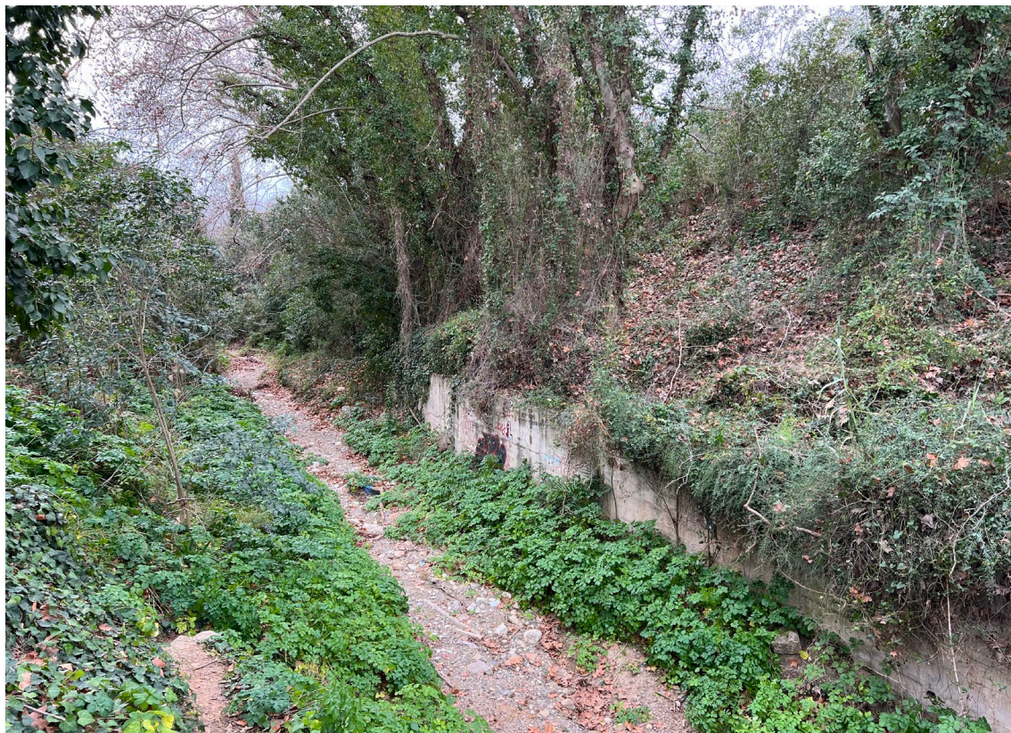
Foto. Tram de barranc amb força vegetació i acumulació de sediments confrontant amb els edificis residencials del barri Gaudí. Font: ©Eduardo Soler
