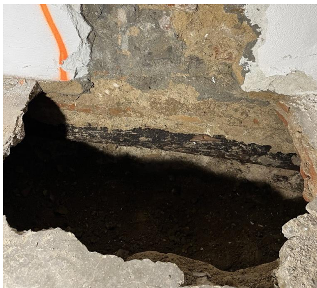
Imatge 3-1. Cala realitzada al tram de l'escala que baixa a planta Soterrani [Font: Windmill]
