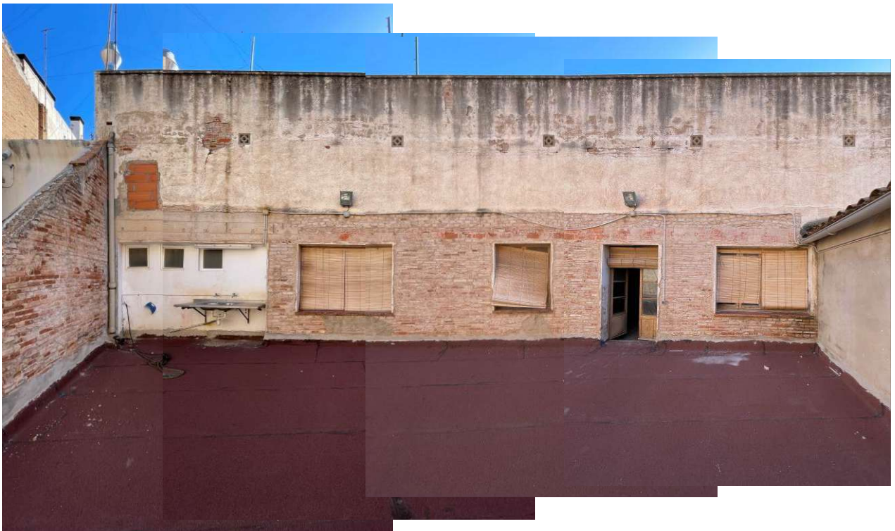
6. Edifici existent. Alçat de la façana de la remunta vista des de la terrassa sobre la Sala del Teatre.
