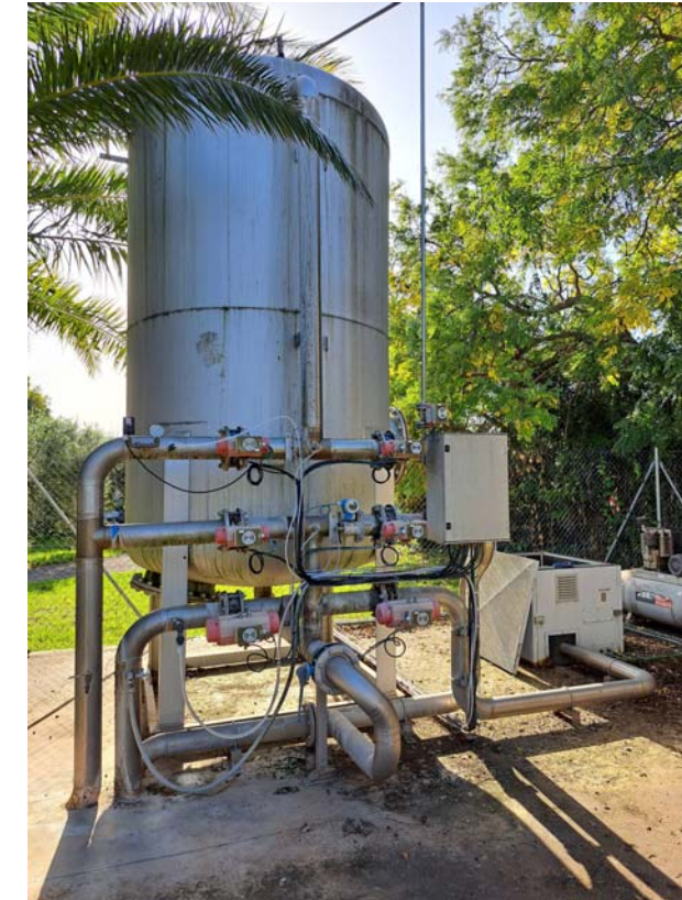
7. Filtració de carbó existent (serà tractament previ de la nova E.T.A.P.)
