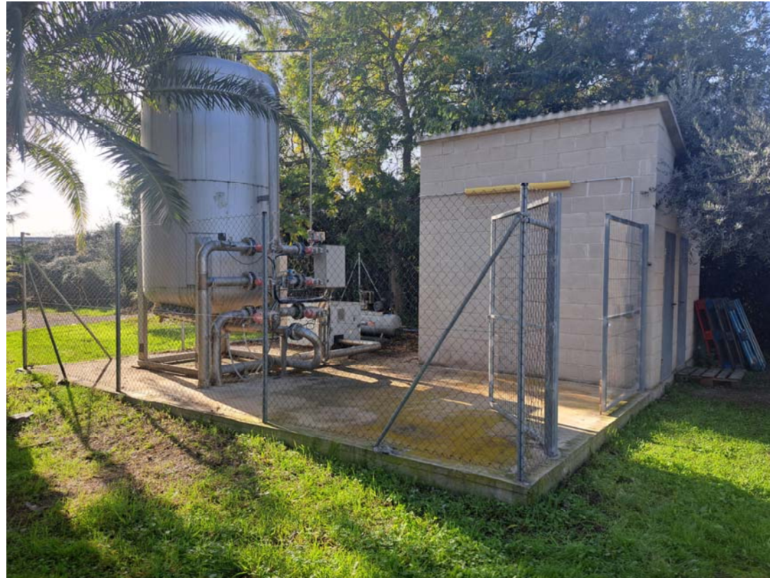
5. Tractament de filtració i cloració actual
