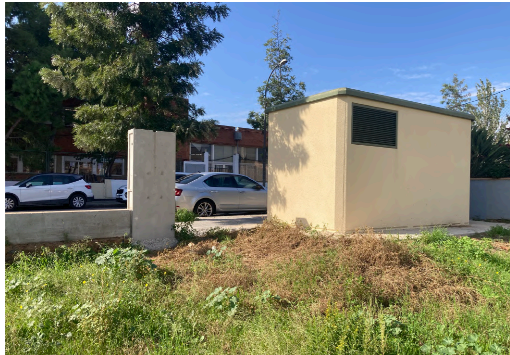
Armari i estació transformadora existent al solar
