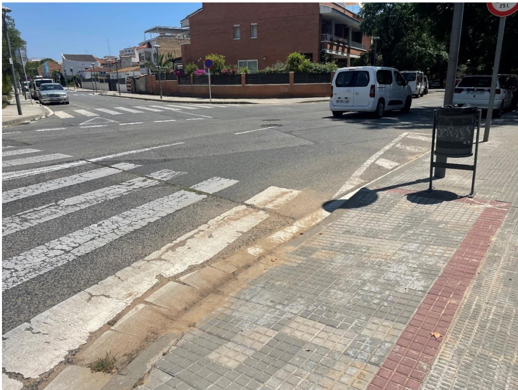
Figura 37. Sedimentación de finos acumulada en la cuneta del paso de cebra de la entrada a la rotonda por el Carrer de la Mare de Déu del Pilar.
