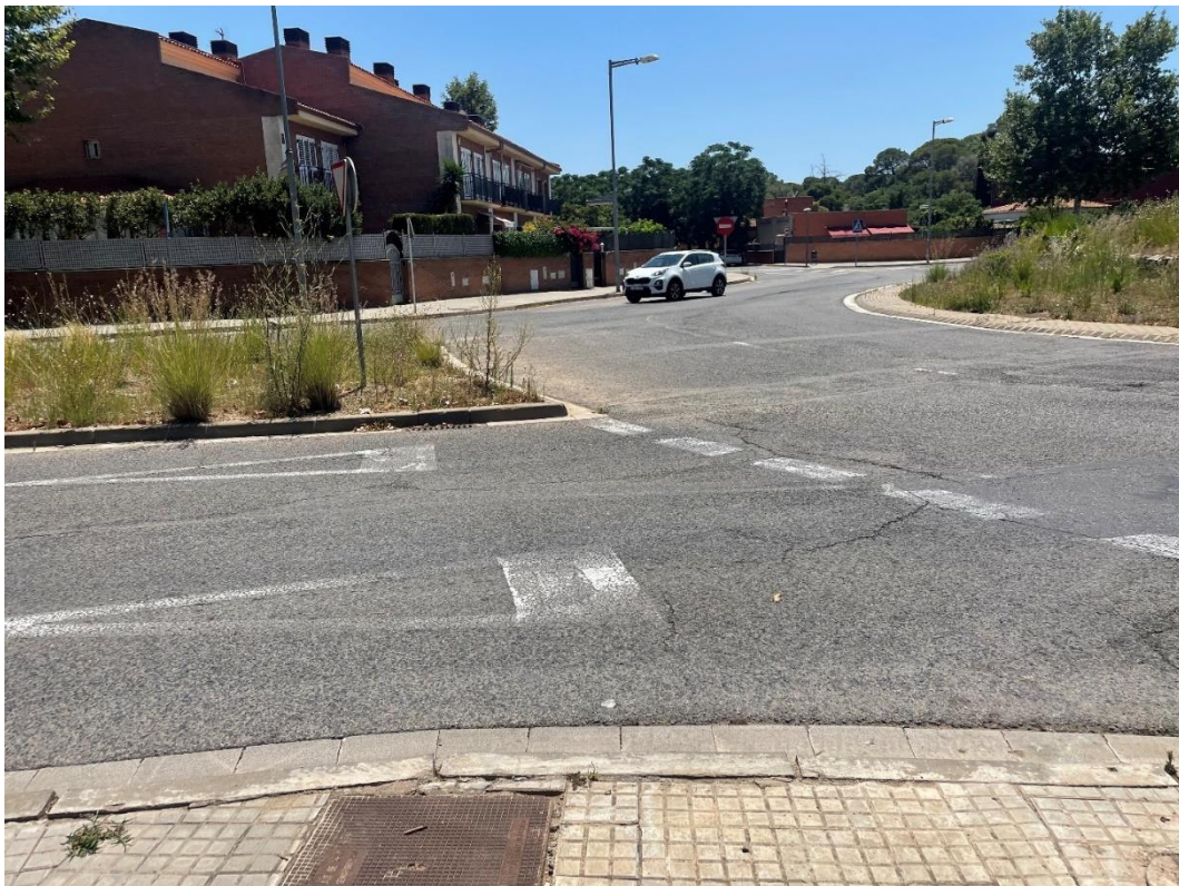
Figura 28. Detalle de la entrada a la rotonda por la zona noreste de la Avinguda de Riudoms donde se aprecia sedimentación de finos.
