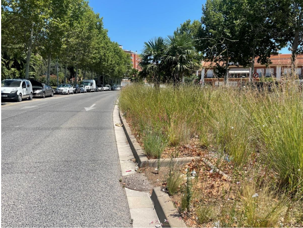
Figura 30. Detalle de pozo de saneamiento PO004242 parcialmente cubierto por sedimentos.
