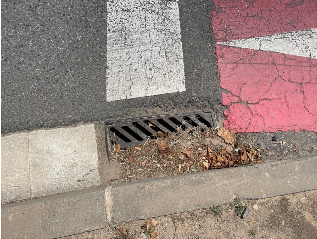
Figura 49. Detalle de imbornal EM1360091 semicolmatado.
