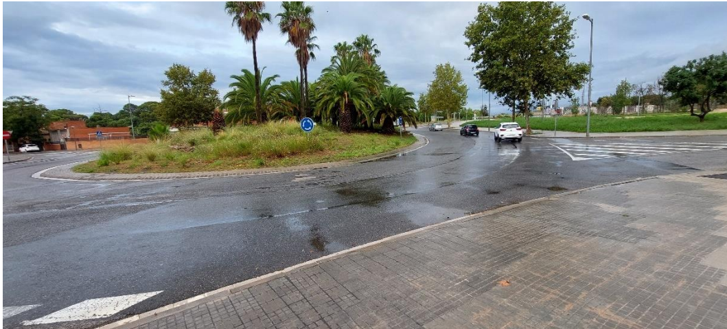
Figura 18. Estado de la zona de circulación de vehículos de la rotonda frente la entrada noreste de la Avinguda de Riudoms donde se aprecia las primeras acumulaciones de agua. Ajuntament de Reus.
