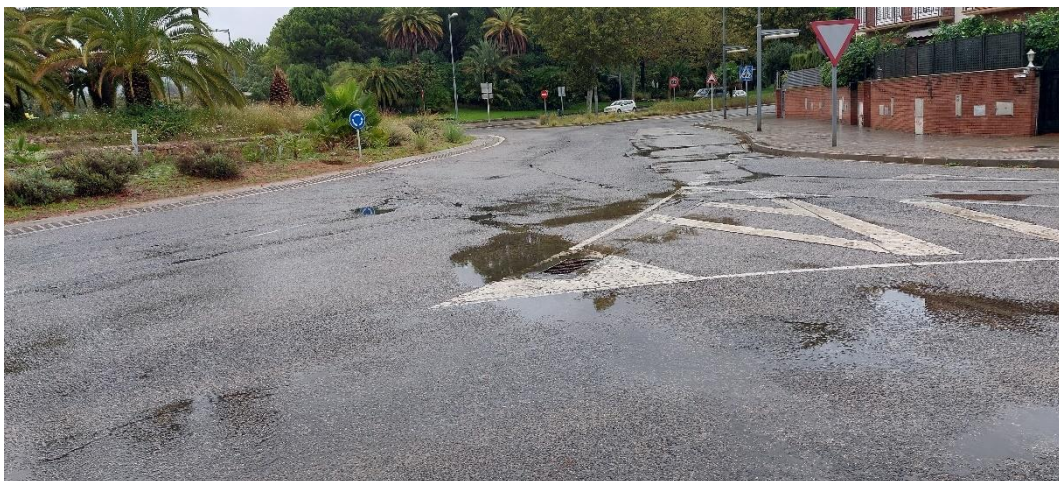
Figura 17. Detalle de la figura anterior de la zona de los imbornales EM013660 y EM1185692. Ajuntament de Reus.
