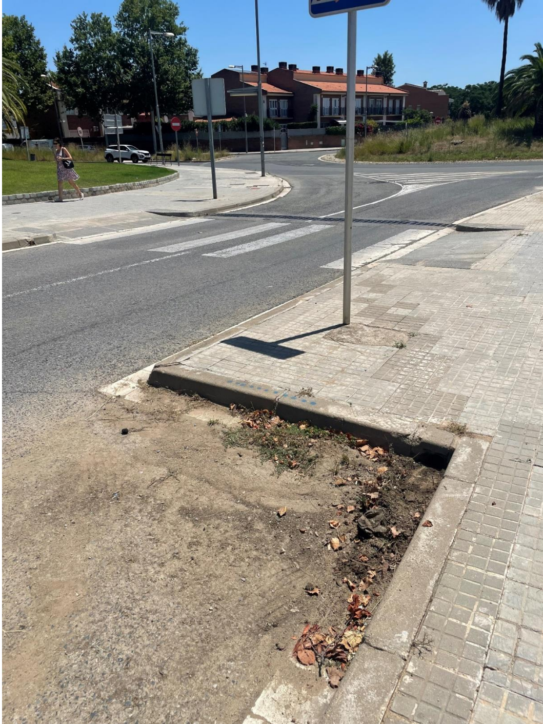
Figura 22. Detalle del arrastre de sedimentos del Carrer de la Ginesta que obstaculiza la entrada de agua a la canalización del aparcamiento.
