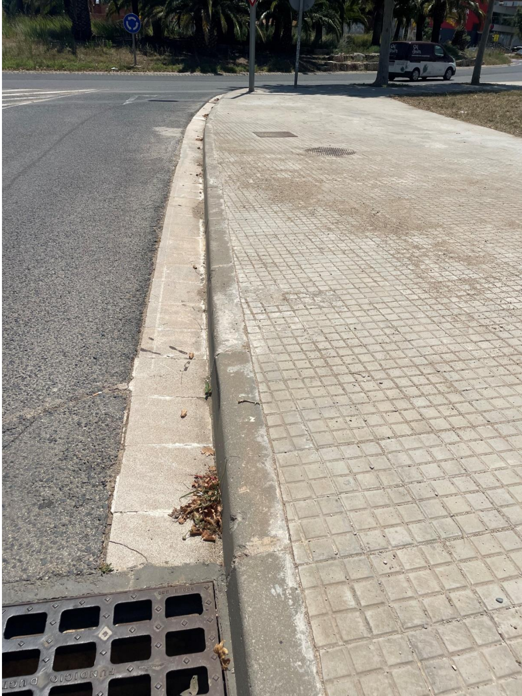
Figura 24. Entrada a la rotonda del Carrer de la Ginesta donde se ve en detalle la cuneta derecha y la acumulación de sedimentos de arrastre en la zona peatonal.
