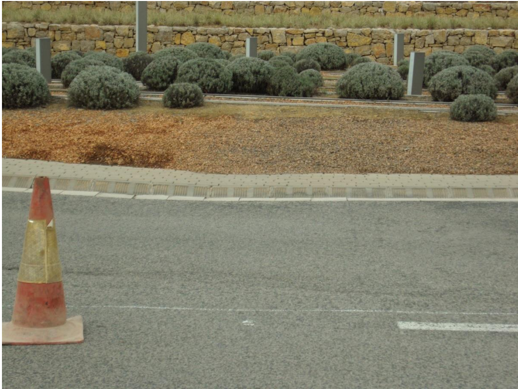
Figura 7. Detalle de hundimiento a reparar frente a Carrer de la Mare de Déu del Pilar. Ajuntament de Reus.
