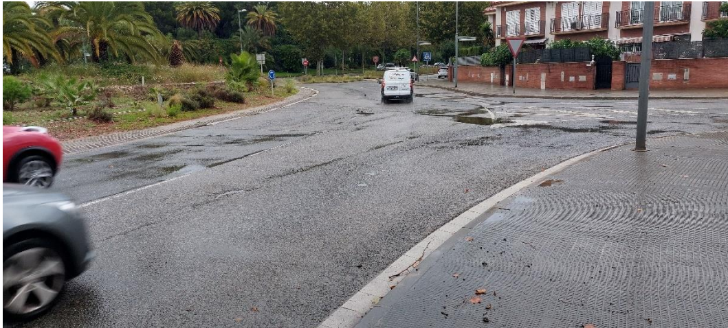
Figura 16. Estado de la zona de circulación de vehículos de la rotonda frente al Carrer de la Mare de Déu del Pilar donde se aprecia las primeras acumulaciones de agua. Ajuntament de Reus.
