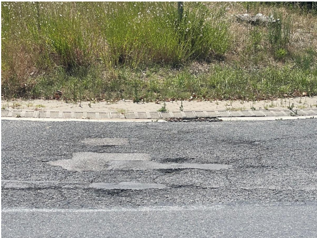
Figura 26. Detalle de imbornal EM1360298 y estado de la carretera cercana a él.
