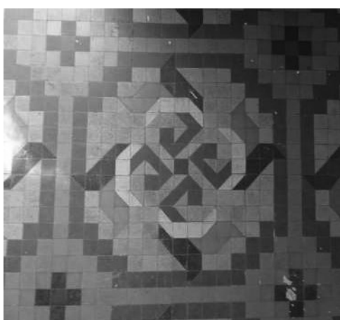
Distribuïdor i sala planta
