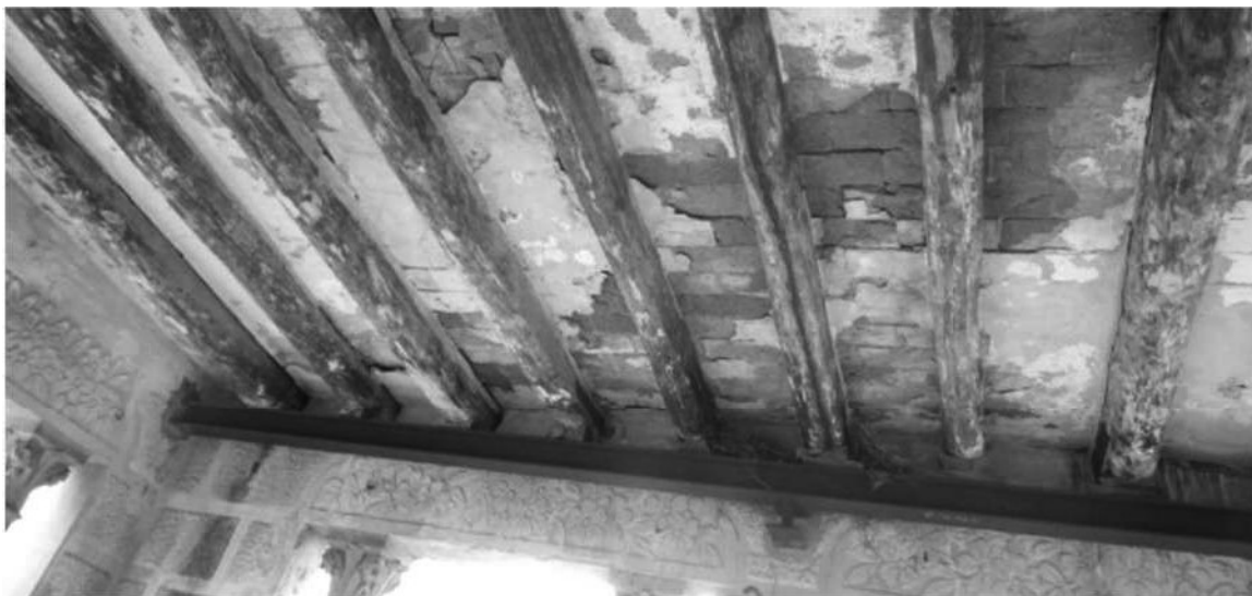
Reforç dels caps dels cairats de la loggia i deteriorament del tauler ceràmic
