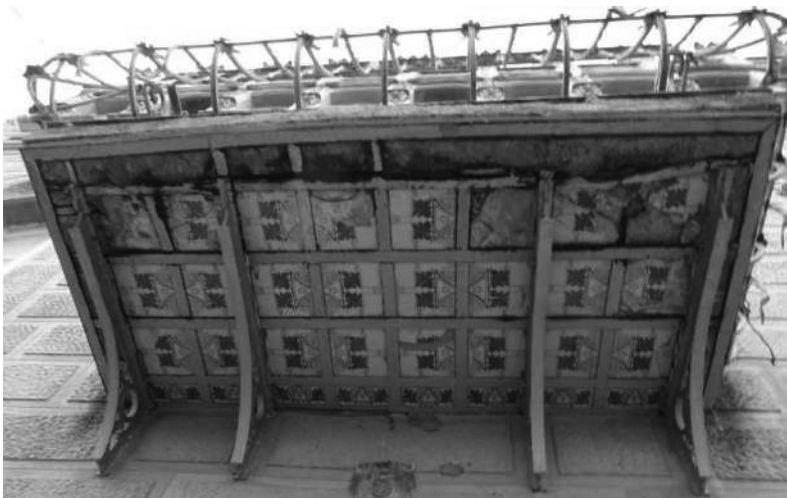
Part inferior del balcó amb el suport d'acer oxidat
