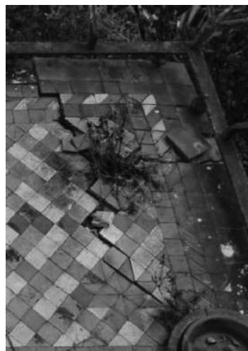
Paviment del balcó esquerdat
