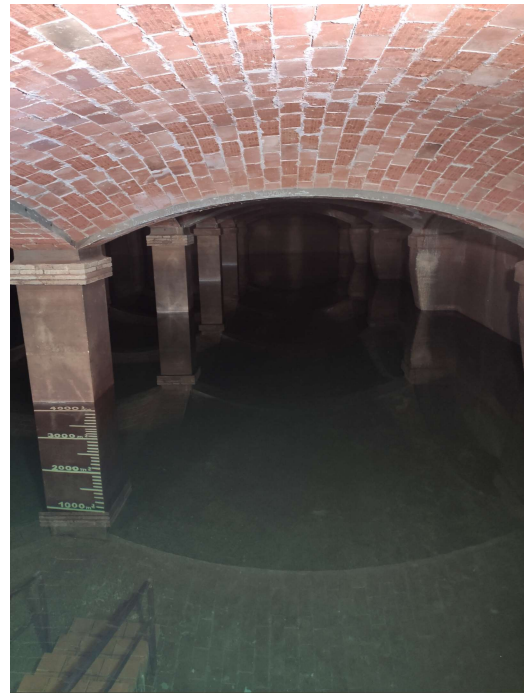
Foto Núm. 6 Dipòsit d'aigua dret
