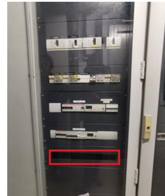
Figura 6 Ubicació elements de protecció instal·lació fotovoltaica al QGD de l'edifici
