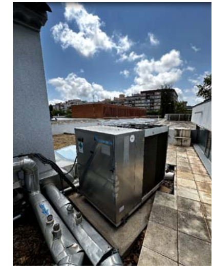
Unitat Exterior Clima Existent a Substituir
