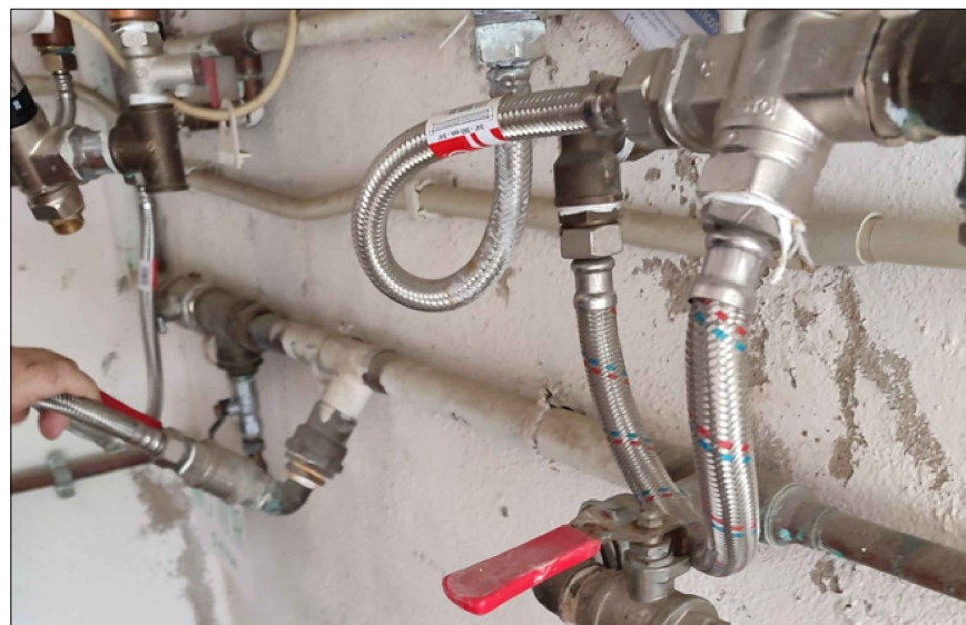
VALVULERIA CONNEXIÓ PRODUCCIÓ AIGUA CALENTA SANITÀRIA
