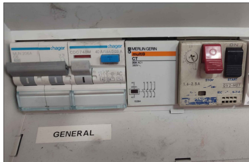
QUADRE ELÈCTRIC EXISTENT
