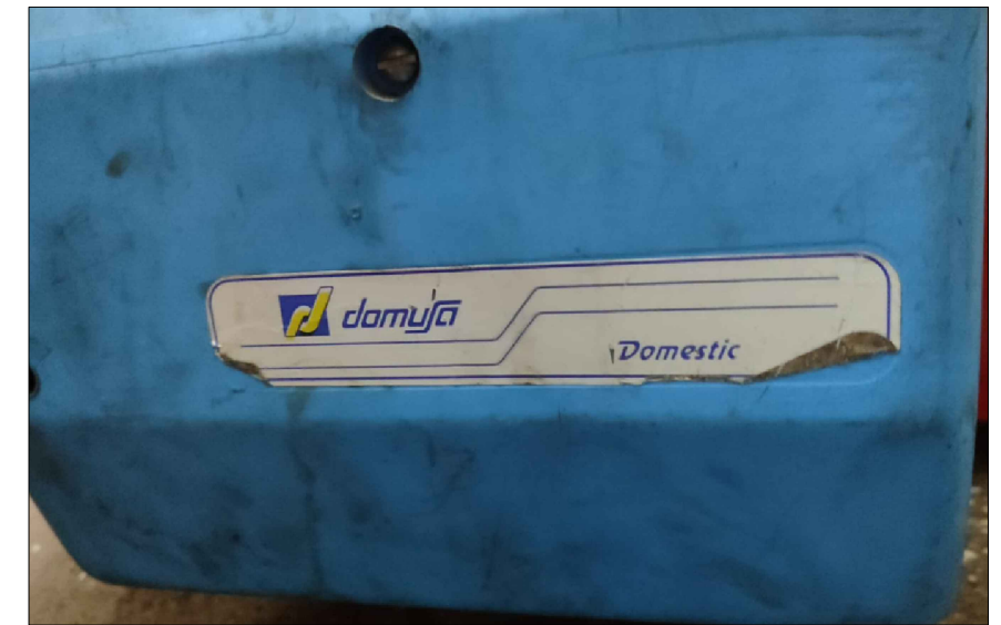
CREMADOR CALDERA GASOIL EXISTENT
