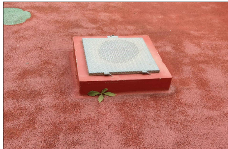
DIPÒSIT SOTERRAT DE GASOIL DE 2.000 LITRES DE CAPACITAT
