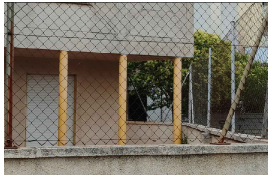
ZONA UBICACIÓ NOVA CALDERA DE GAS NATURAL
