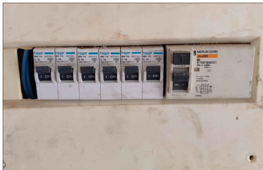
QUADRE ELÈCTRIC EXISTENT
