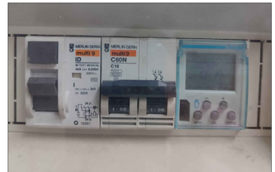
QUADRE ELÈCTRIC EXISTENT
