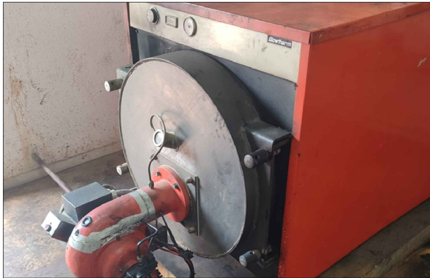
CALDERA DE GASOIL A ELIMINAR DE 175 KW DE POTÈNCIA
