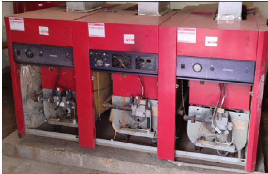
CALDERES MODULARS EXISTENTS (3) DE 330 KW DE POTÈNCIA
