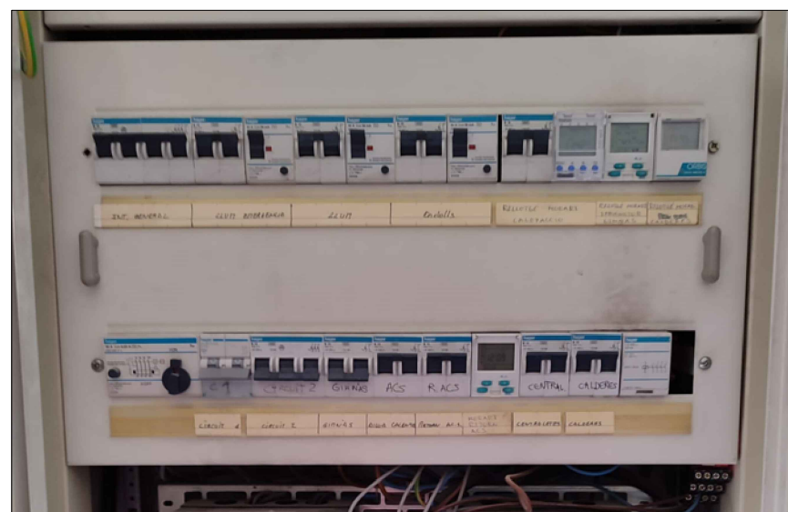
QUADRE ELÈCTRIC EXISTENT
