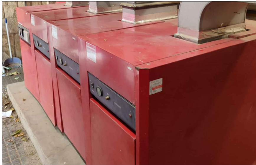
CALDERES MODULARS EXISTENTS DE 553 KW DE POTÈNCIA
