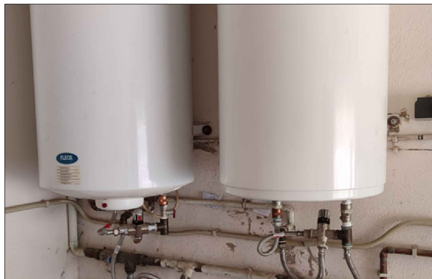
PRODUCCIÓ AIGUA CALENTA EXISTENT. TERMO ACUMULADORS ELÈCTRICS
