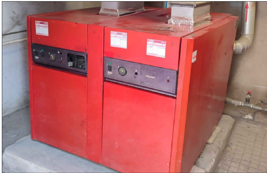
CALDERES MODULARS EXISTENTS DE 276,50 kW DE POTÈNCIA
