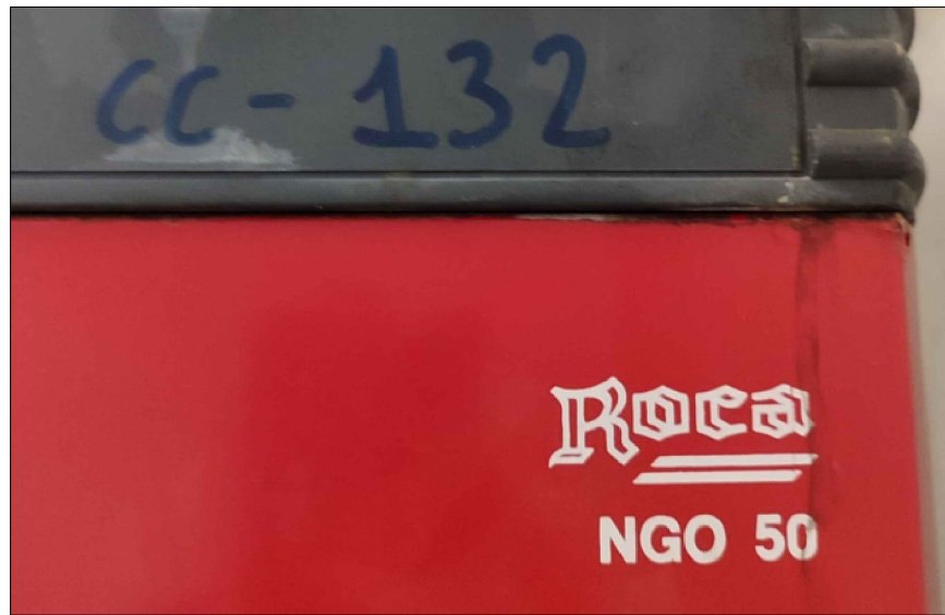
CALDERA EXISTENT DE GASOIL
