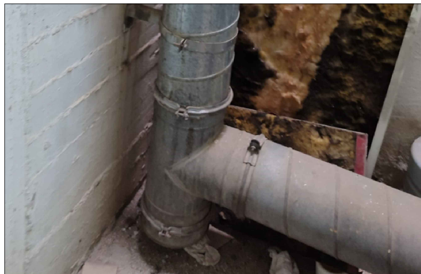
SORTIDA DE FUMS CALDERA DE GASOIL EXISTENT
