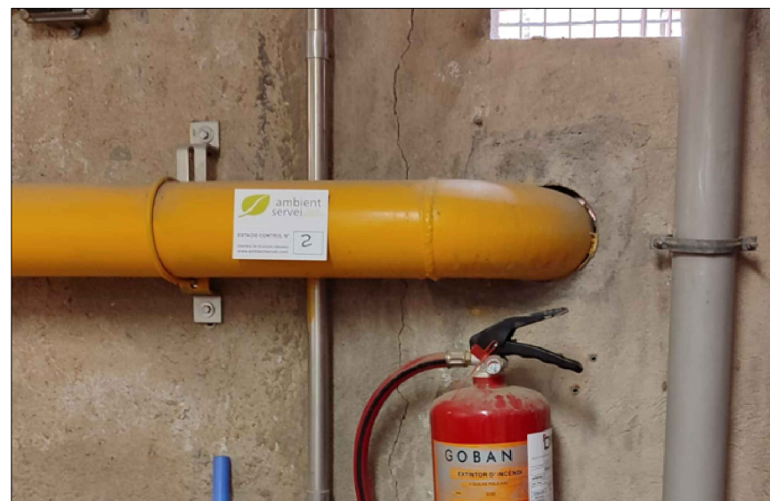
SUBMINISTRAMENT DE COMBUSTIBLE A CALDERES (GAS NATURAL)
