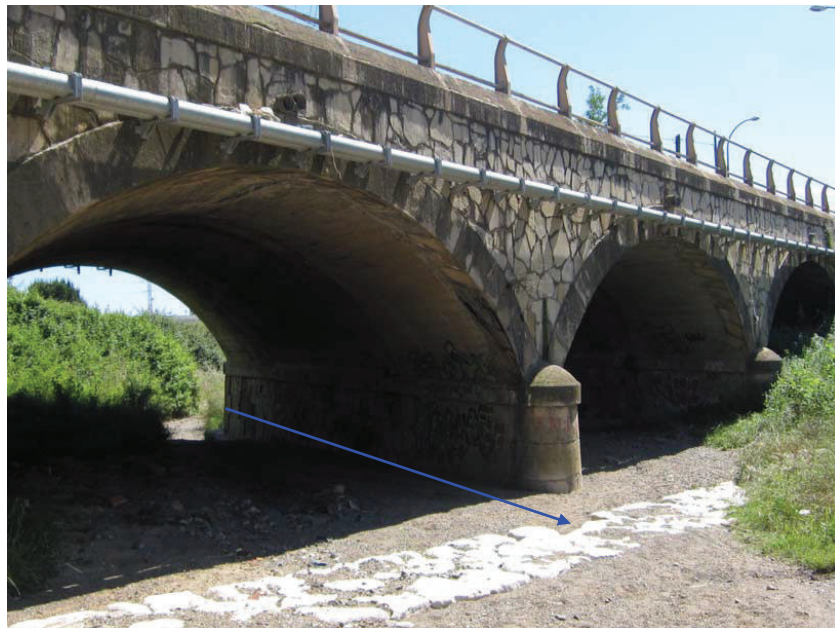
Foto 3. Obra de pas sota la carretera de Montblanc. Límit sector E.2 aigües amunt
