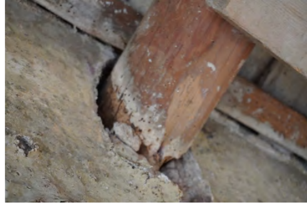
Imatge 6. Afectació cap biga (Bigues A-01 - A-10)
