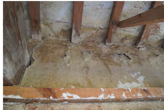
Imatge 11. Degradació de del revestiment
