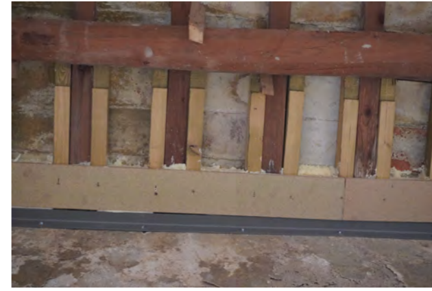
Imatge 4. Teulada amb estructura de fusta, llates i tauler de rajols ceràmics. Reforç d'urgència caps llates amb angular laminat i llisons de fusta
