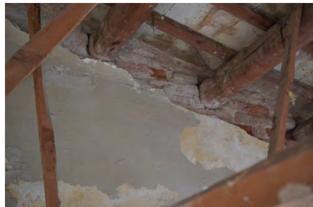
Imatge: F5. Degradació parament. Filtracions i humitat.
