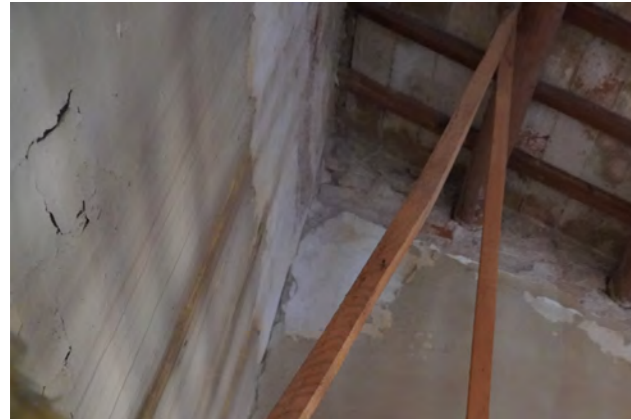
Imatge: F3. Degradació parament. Filtracions i humitat.
