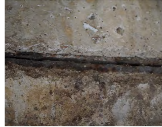
Imatge: F1. Oxidació perfil laminar.
