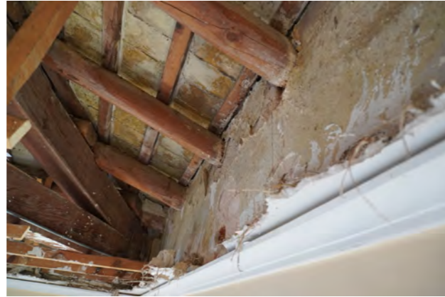
Imatge: F2. Degradació parament. Filtracions i humitat.
