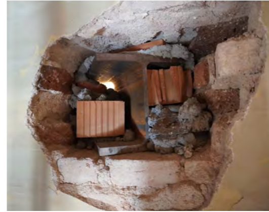
Imatge: F2. Forat mur. Biga metàl·lica suport maquinària clima.
