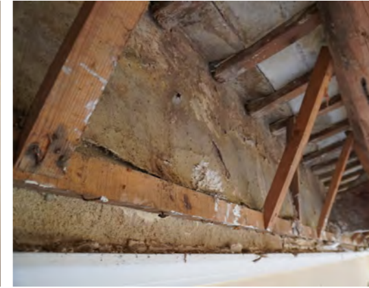
Imatge: F3. Degradació parament. Filtracions i humitat.
