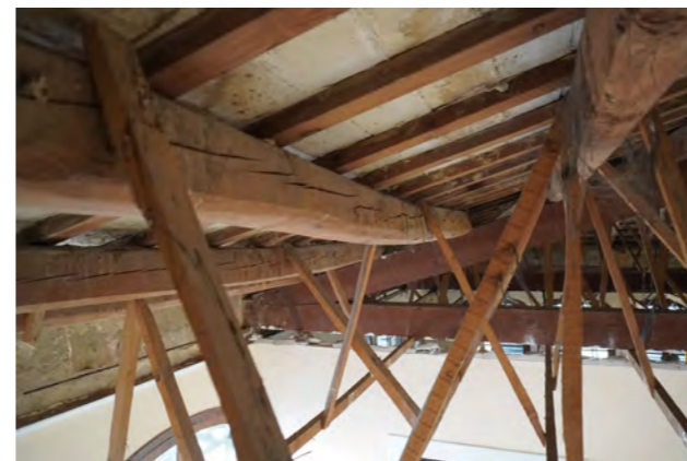
Imatge 3. Deformació i clivelles biga D-03, reomplir amb resines d'epòxid.
