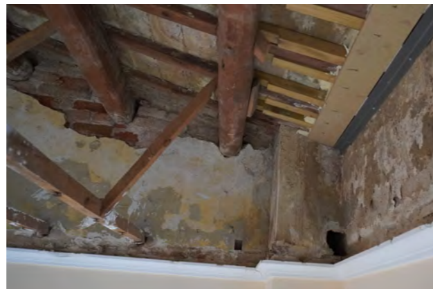
Imatge: F6. Degradació parament. Filtracions i humitat.
