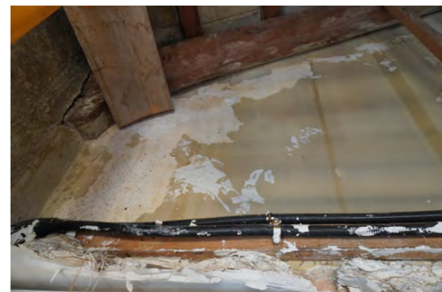
Imatge: F5. Degradació parament. Filtracions i humitat.
