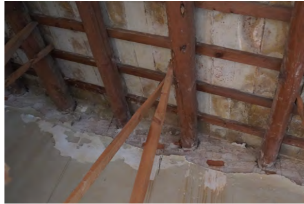
Imatge: F4. Degradació parament. Filtracions i humitat.
