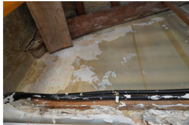
Imatge 10. Degradació de del revestiment
