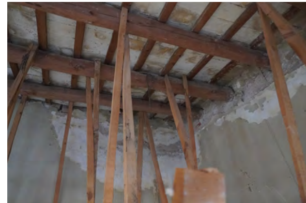
Imatge: F4. Degradació parament. Filtracions i humitat.
