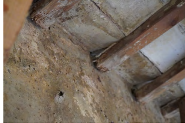
Imatge 7. Afectació caps llates
