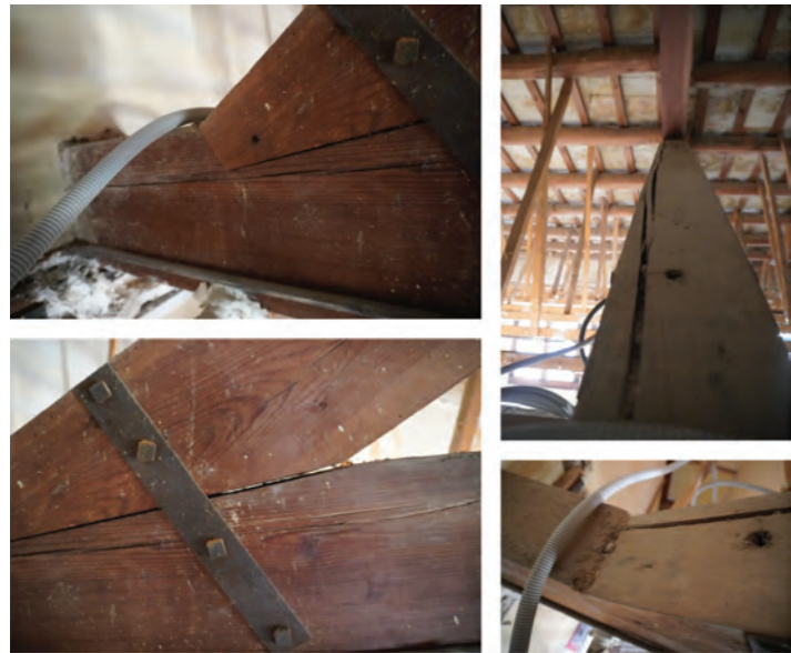
Estat actual unió tornapunta - tirant Cavall III - a reparar
