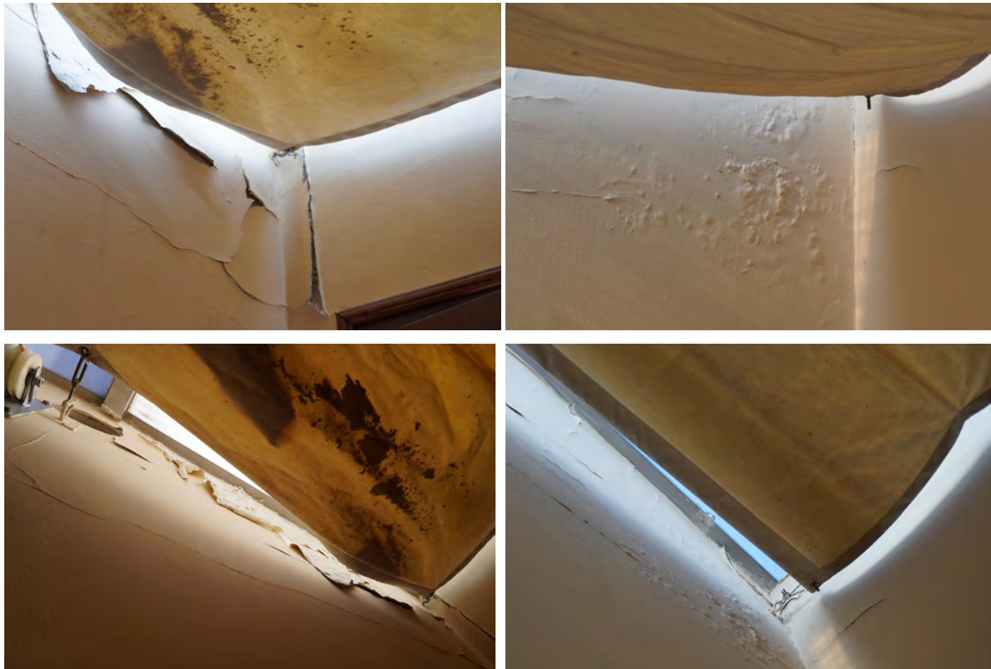
Imatge 030 - Deterioraments de la part superior dels paraments interiors dels tancaments del badalot de l'escala
