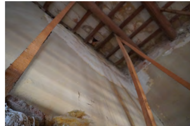
Imatge 12. Degradació de del revestiment
