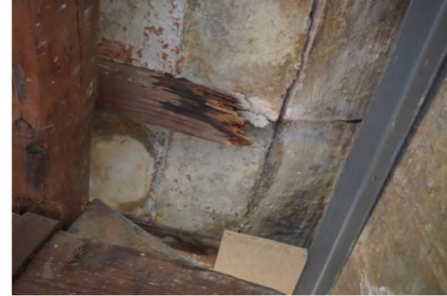
Imatge 8. Llata col·lapsada, fisura i descens tauler ceràmic
