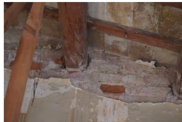
Imatge 2. Revisar caps bigues D-01 a D-09. Reforç estructural, si s'escau.
