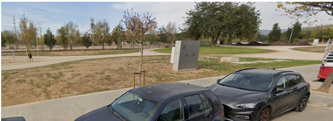
Figura núm.1 Instal.lacions existents: Escomesa i quadre elèctric maniobra i control
