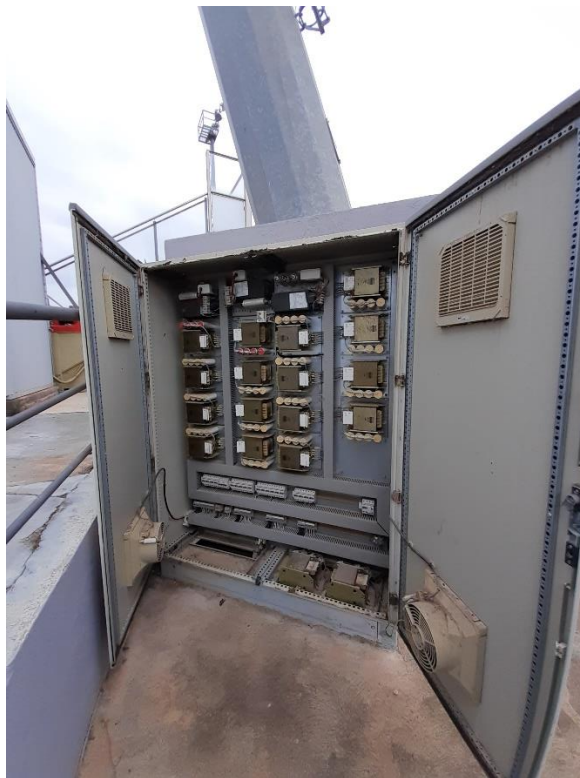
Imatge 20. Quadre de drivers de les torres d'il·luminació de l'estadi municipal
