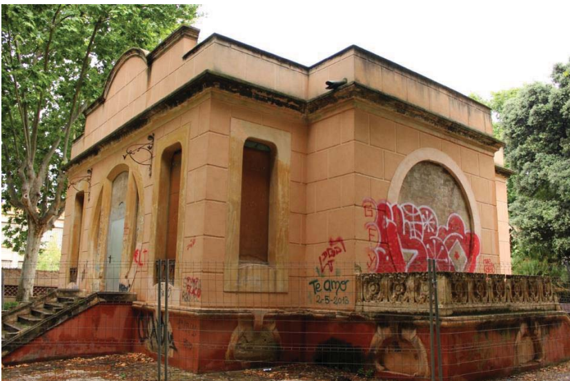
Vista de l'edifici des del costat est, on s'observen pintades de caràcter bandàlic (foto: P.A.C.).
