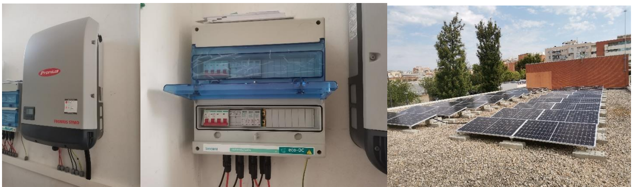
Figura 4 Equips elèctrics de la instal·lació fotovoltaica actual
