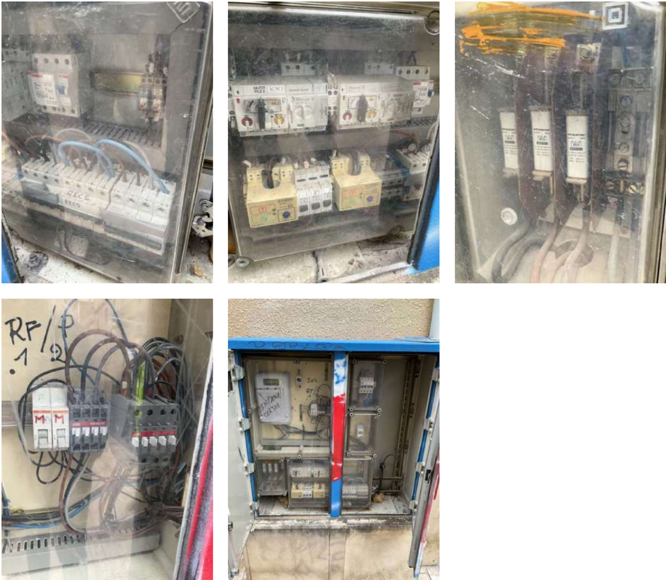
QUADRE D'ENLLUMENAT JS EXISTENT A SUBSTITUIR
