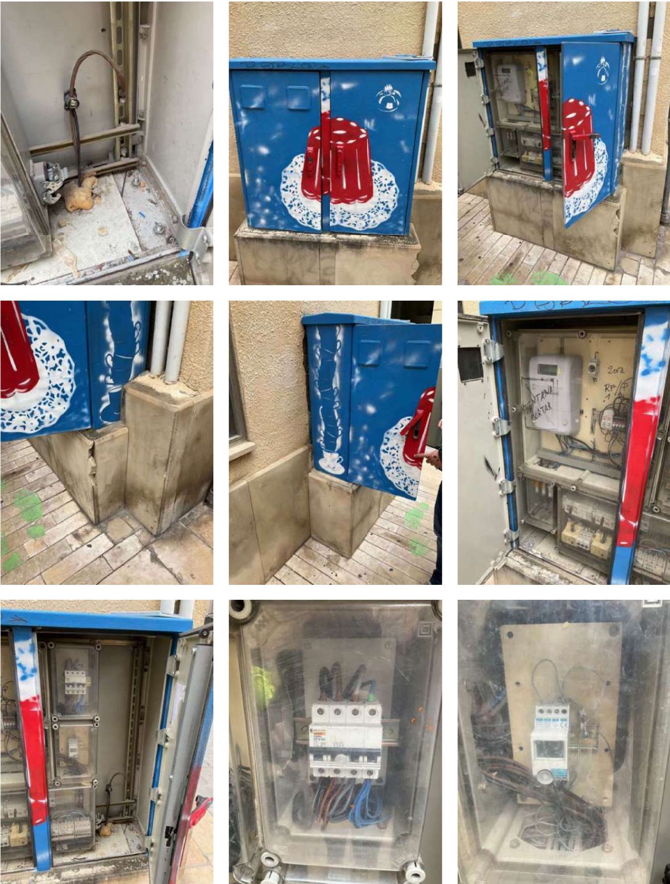
QUADRE D'ENLLUMENAT JS EXISTENT A SUBSTITUIR
