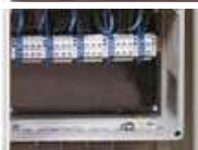
Espacio para conexiones
