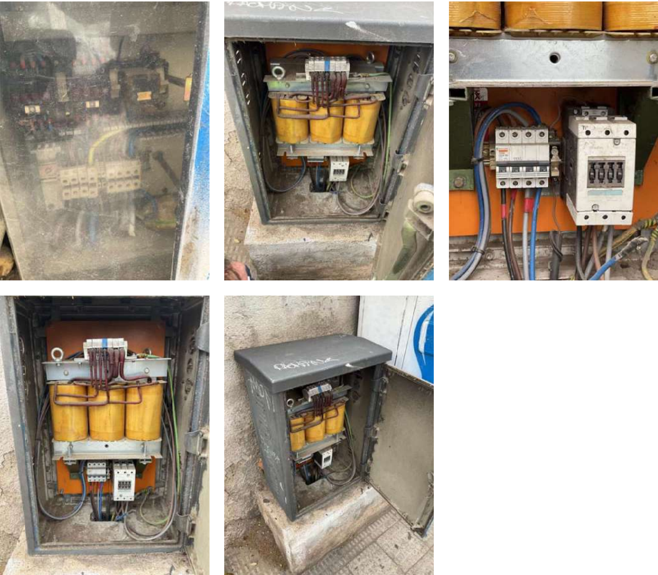
QUADRE D'ENLLUMENAT IY EXISTENT - TRAF0
