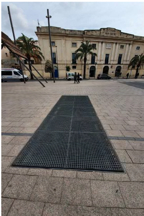
Foto 16. Reixa ventilació natural aparcament de les Oques
