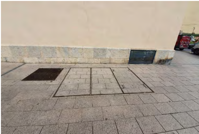
Foto 13. Estació transformadora soterrada en desús
