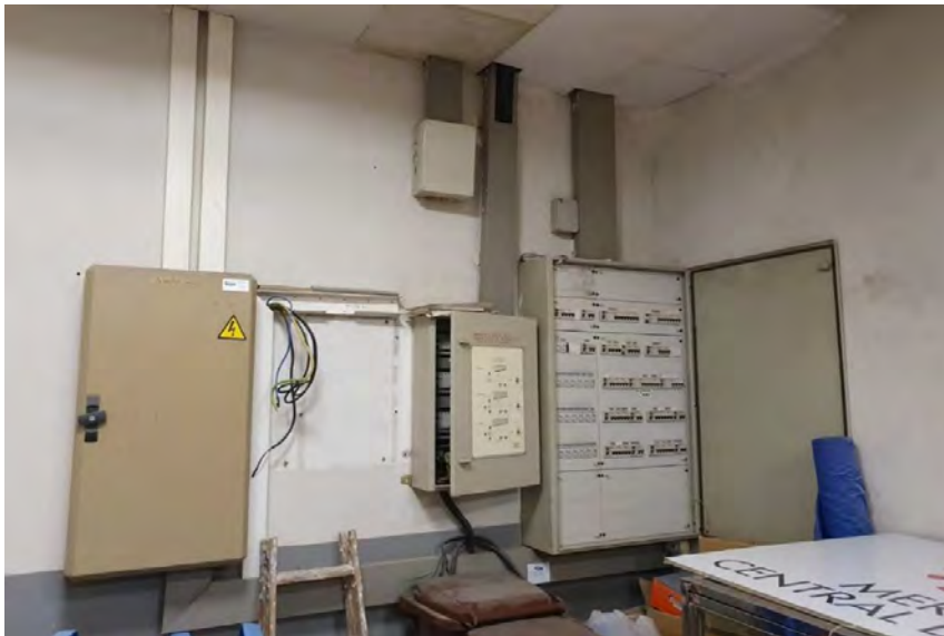
Foto 7. Quadres elèctric situat a la zona de magatzem del supermercat
