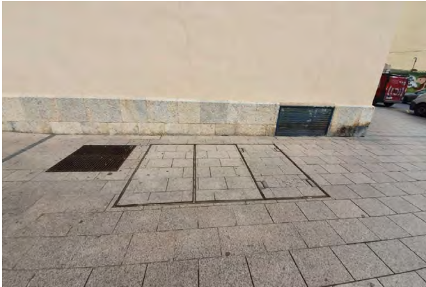
Foto 14. Estació transformadora soterrada en desús
