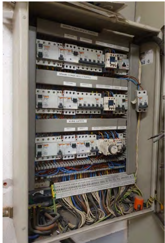
Foto 11. Estat actual quadres elèctrics
