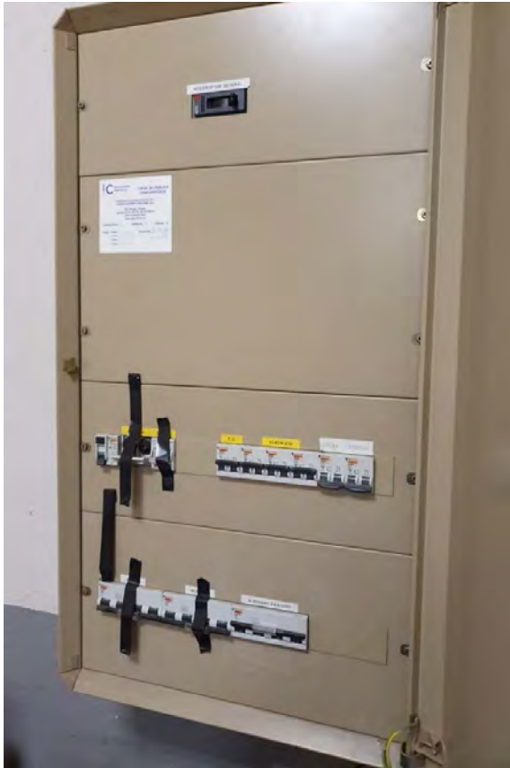
Foto 10. Estat actual quadres elèctrics
