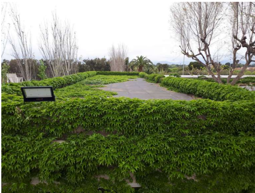
Figura 4. Coberta de l'edifici bufants
