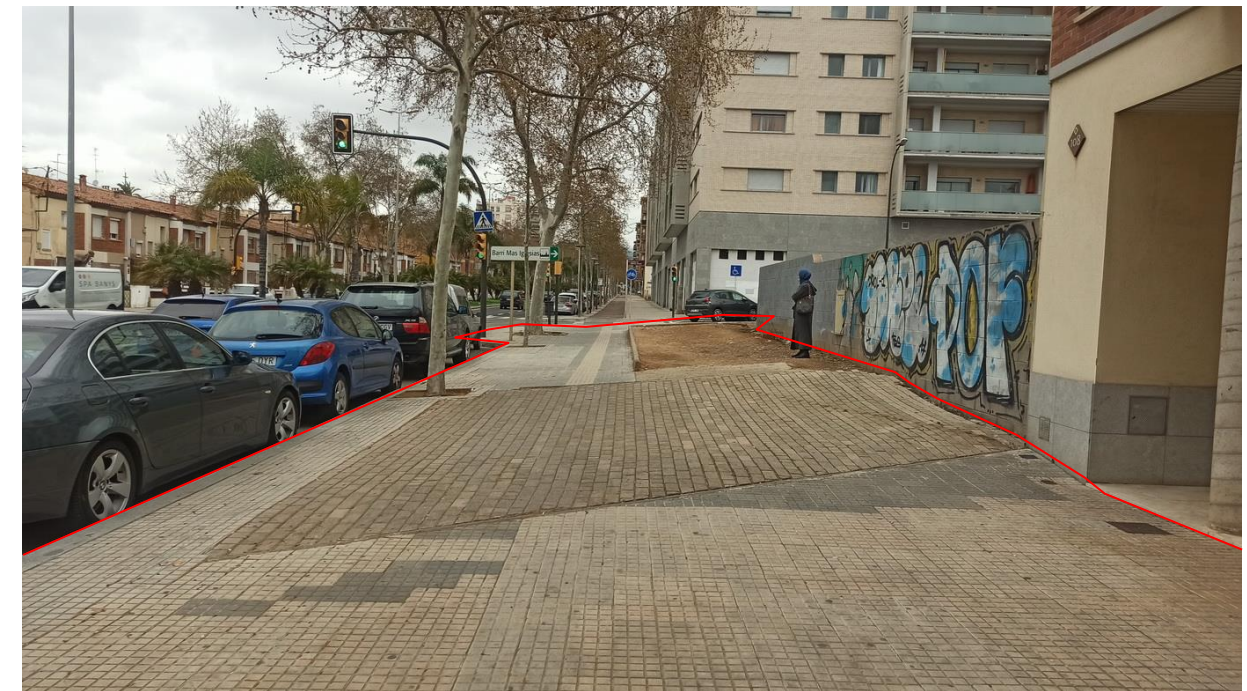
Figura 11. Paviment per a vianants a reparar. Tram 1.
