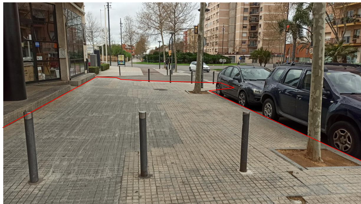
Figura 10. Paviment per a vianants a reparar. Tram 1.
