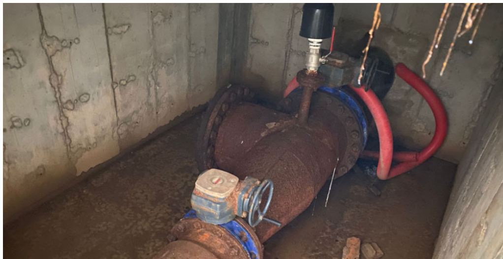
Figura núm.10 Punt connexió PK 0+247, equips mecànics a renovar en arqueta existent
