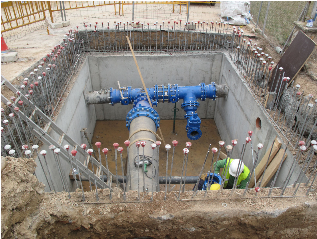
Figura núm.3 Punt de connexió Pk 0+000, equips mecànics
