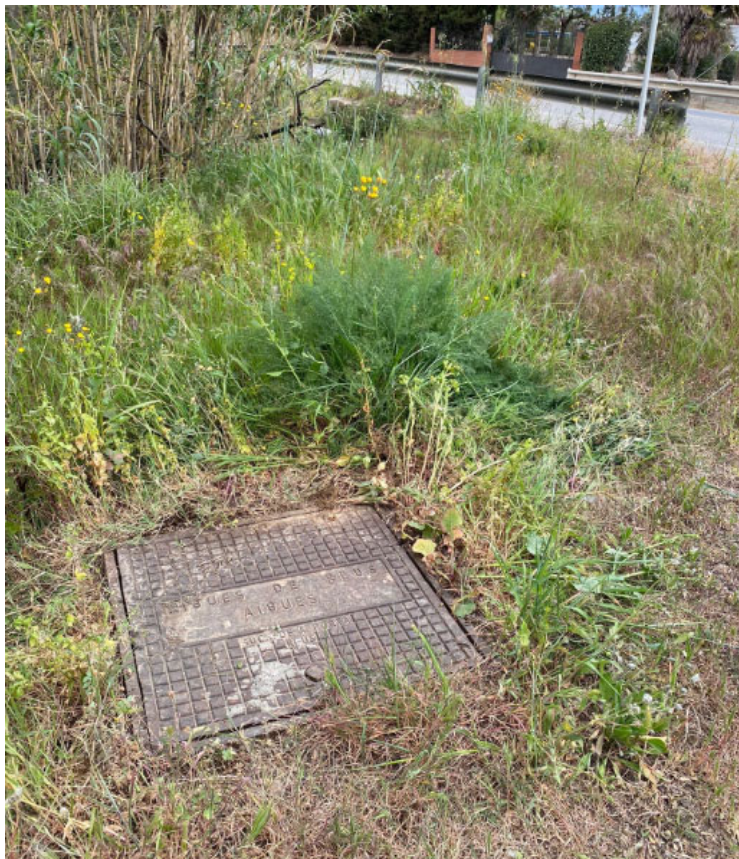
Figura núm.8 Punt connexió PK 0+244, entrada arqueta existent
