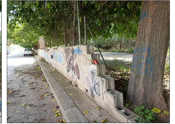
VISTA TANCA A RECONSTRUIR
