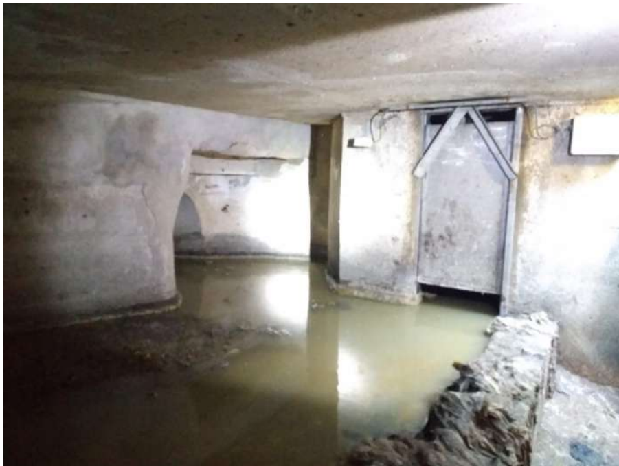
Figura 3. Interior de l'arqueta de sobreeiximent
