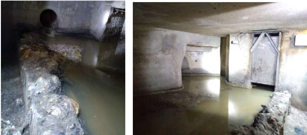
Figura 2: Imatge de la situació actual de l'interior de l'arqueta de sobreiximent
