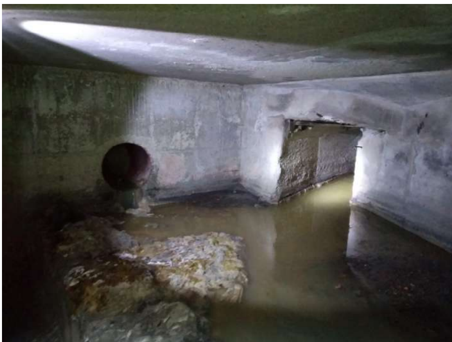
Figura 4. Interior de l'arqueta de sobreeiximent
