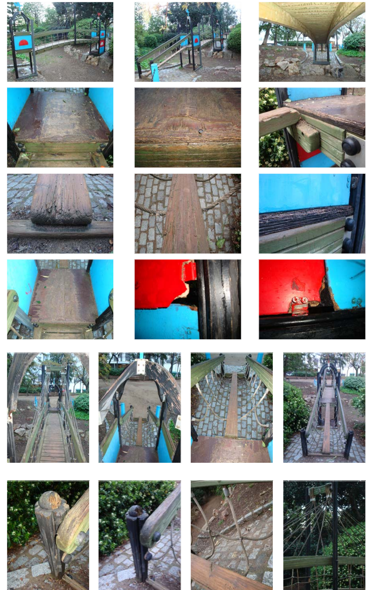
FOTOS DE L'ESTAT ACTUAL DEL PONT DEL PARC TIRANT LO BLANC A REPARAR
