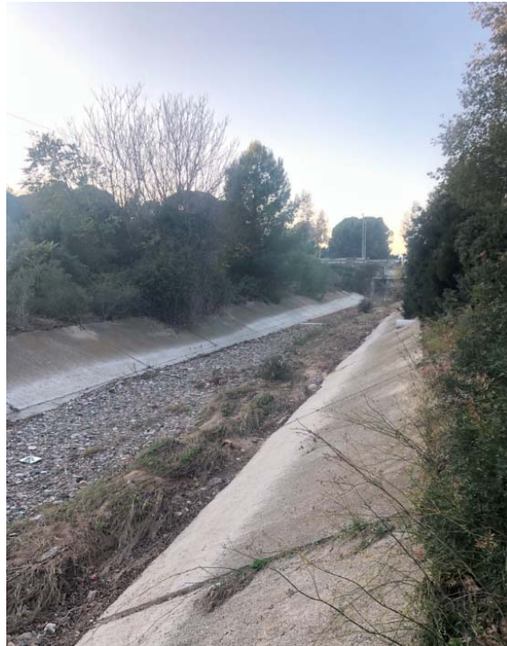
Figura núm.1 Barranc de la Immaculada, amb acumulació de brossa i canyes als marges en el començament a l'avinguda de Riudoms
