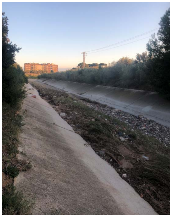
Figura núm.2 Llera del barranc de l'Immaculada amb acumulació de vegetació en la part propera al carrer del Migdia
