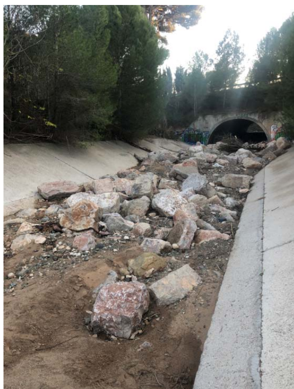
Figura núm.8 Tram final del barranc de la Immaculada amb acumulació de pedres i elements arboris en e pas sota la carretera T-11.
