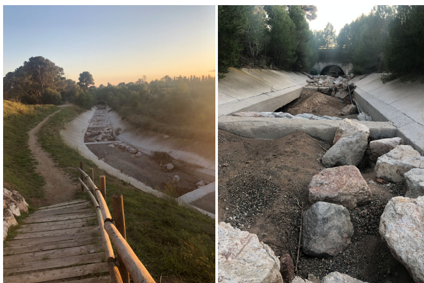
Figura núm.1 Tram del barranc de Pedret amb arrossegament del mantell de protecció
