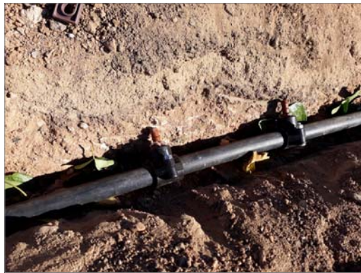
DETALL DE TUB DE DISTRIBUCIÓ D'AIGUA DE GOTEIG. DETALL DEL TUB DE GOTEIG INTEGRAT TOCANT A TAULÓ DE JARDINERIA PER REFORÇAR HUMITAT
