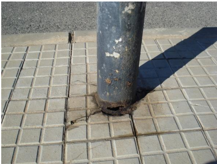
Suport afectats per la corrosió de la base
