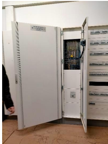
Figura 6 Sala elèctrica escola
