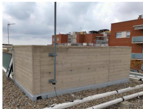
Figura 6 Zona equips elèctrics
