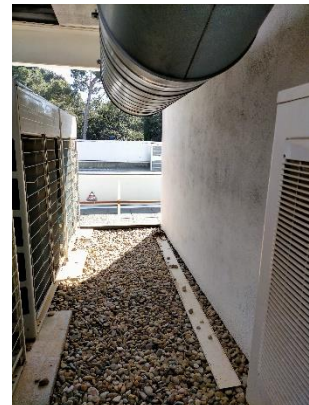
Figura 6 Zona equips elèctrics
